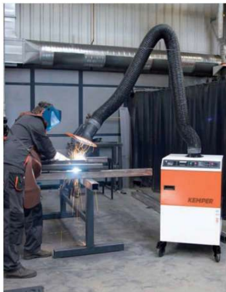
Installation d'aspiration filtration
